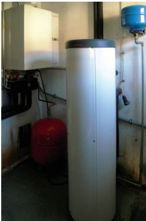
Slika 13: Novi kotel na plin
