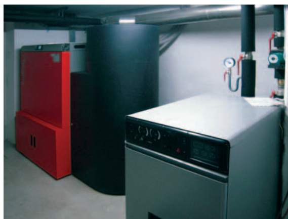
Slika 10: Novi kotel na pelete
