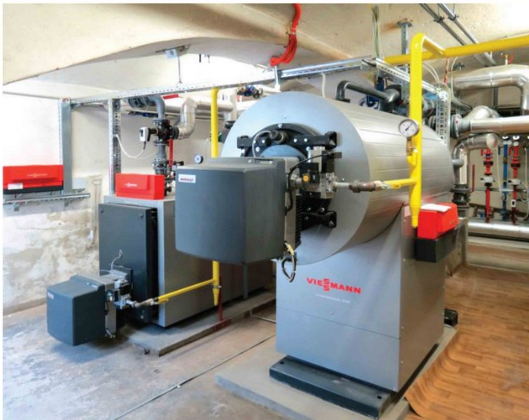
Slika 7: Nova kotlovnica v OŠ Toneta Čufarja Maribor
