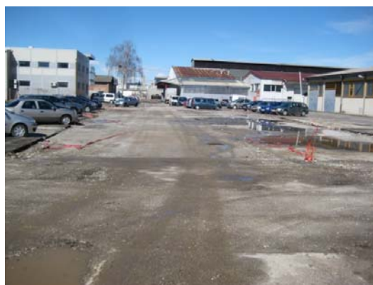
Stanje po rušitvi
