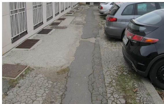
Slika 2.2: Dotrajan ustroj pri hodniku za pešce pri stavbi SŽ.
