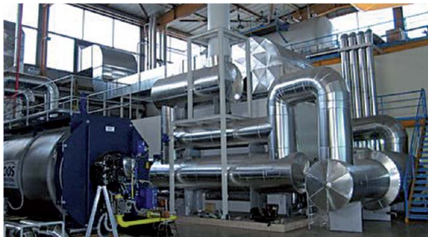
Slika 1: TOM I. – kogeneracijsko postrojenje
