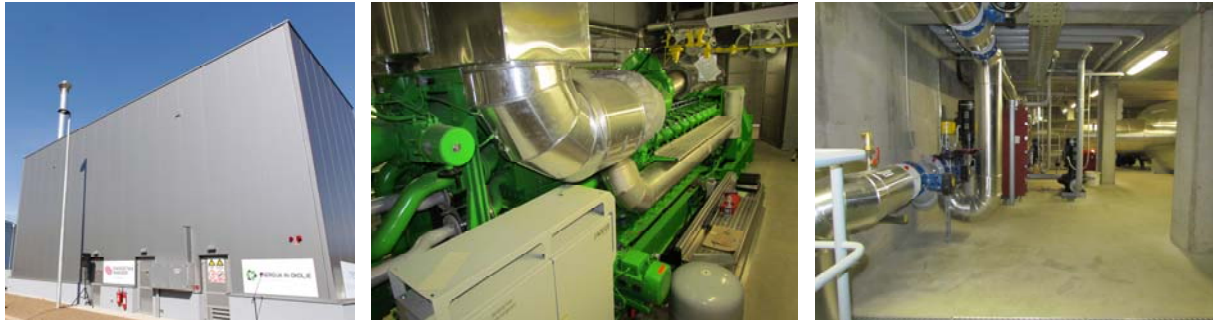
Slika 3: Objekt TOM III. – kogeneracijsko postrojenje
