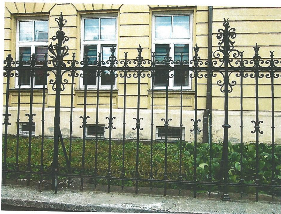
Slika 2: Obstoječa kovinska zunanja ograja ob severni fasadi šolske stavbe
