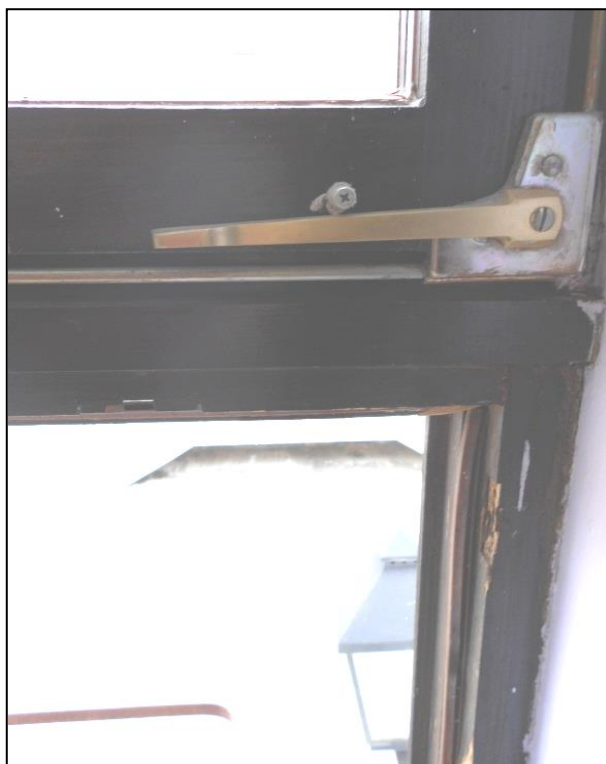
Slika 4: Fotografija dotrajanega okna v enoti Pristan.
