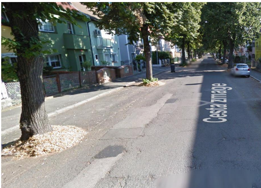
Slika 8: Poškodbe na obstoječem cestišču
