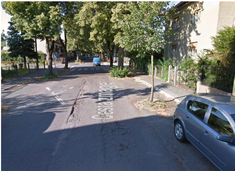
Slika 9: Poškodbe na obstoječem cestišču
