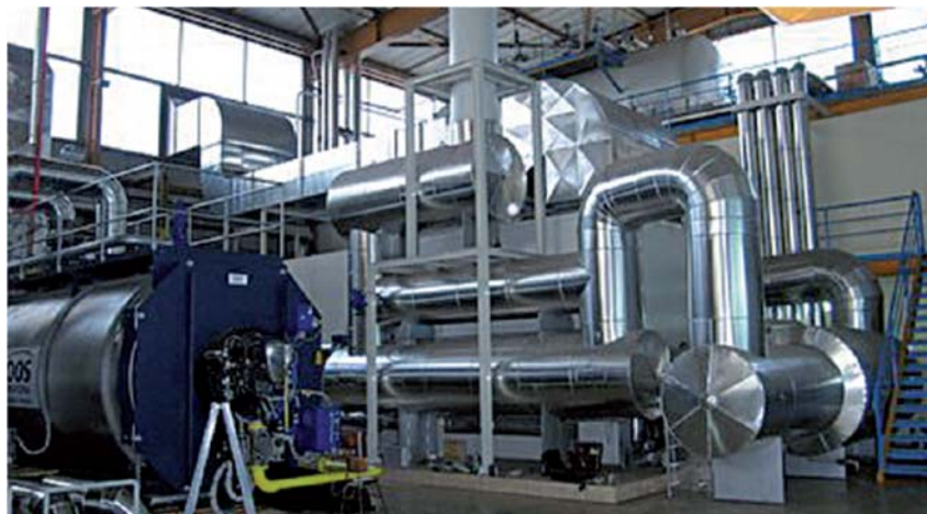
Slika 1: TOM I. – kogeneracijsko postrojenje
