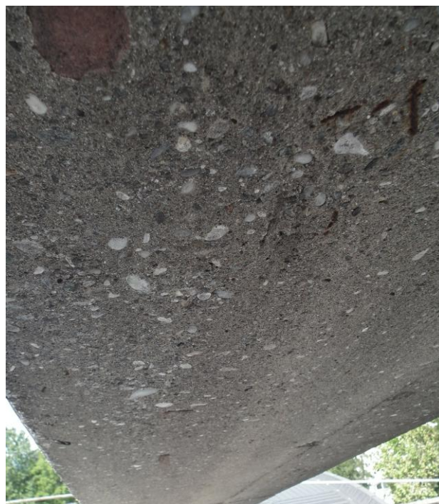
Slika 51: beton spodnje površine nosilca
