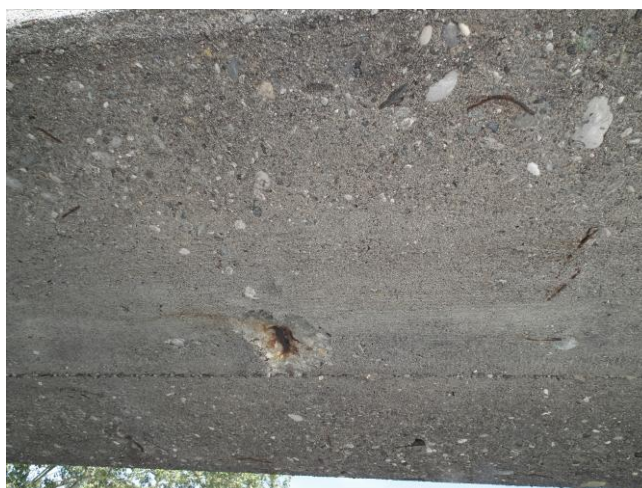
Slika 61: lokalna mesta odpadanje zaščitnega sloja, korozija armature
