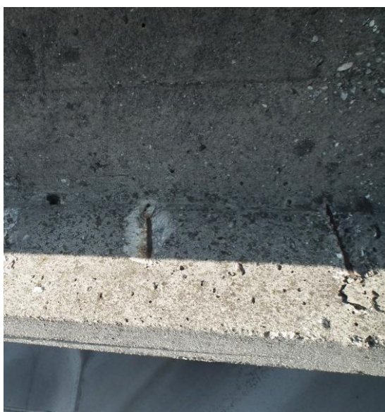
Slika 16: odpadanje zaščitnega sloja betona spodnje pasnice
