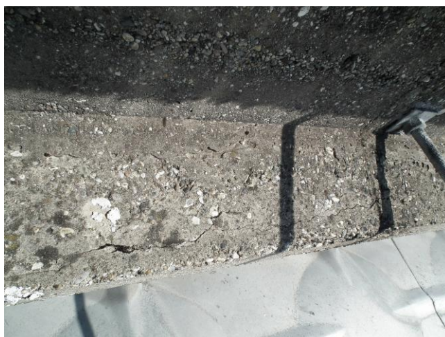
Slika 56: vzdolžna razpoka v spodnji pasnici
