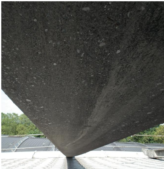
Slika 32: beton spodnjega dela spodnje pasnice
