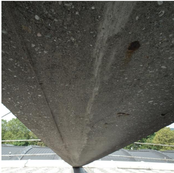
Slika 41: beton spodnjega dela spodnje pasnice
