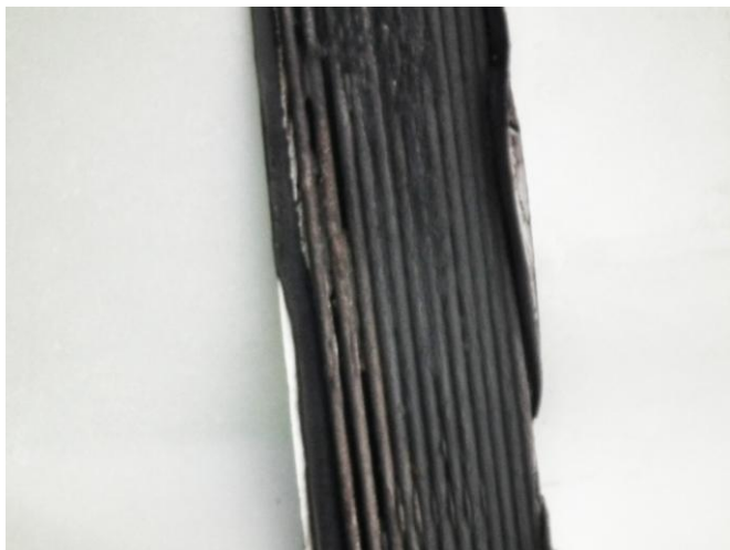
Slika 134: korozija žic pramena v vmesnih poljih
