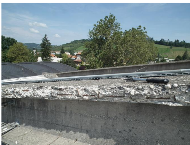
Slika 42: odpadanje betona roba, močna korozija armature
