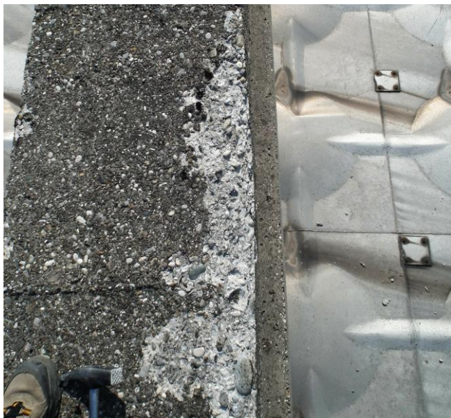
Slika 18: razpad betona roba gornje pasnice
