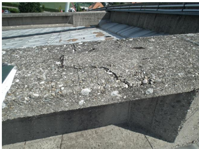
Slika 52: stanje betona v predelu sidrne glave ob glavnem nosilcu
