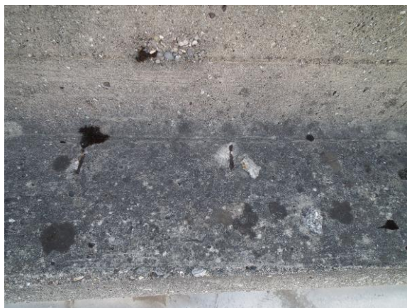
Slika 74 odstopanje betona, armatura korodirana
