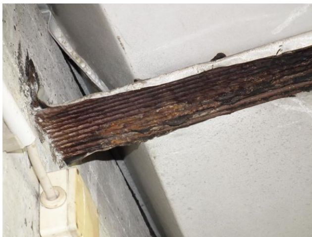
Slika 128: intenzivna korozija žic pramena desno od S8
