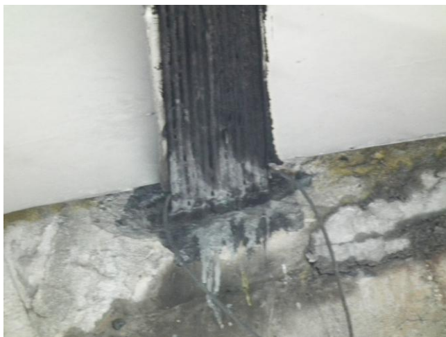
Slika 115: površinska korozija prednapetih žic
