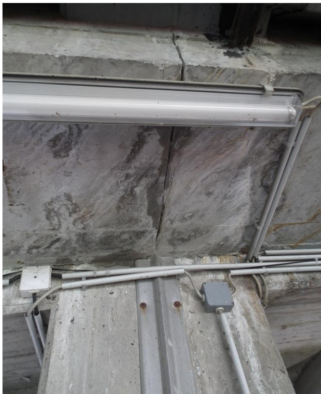
Slika 121: zatekanje vode skozi dilatacijo 5. stebra
