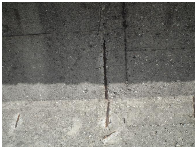
Slika 69: odstopanje betona, armatura korodirana
