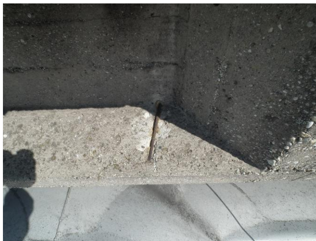
Slika 54: stanje betona v predelu spodnje pasnice, armatura je korodirana
