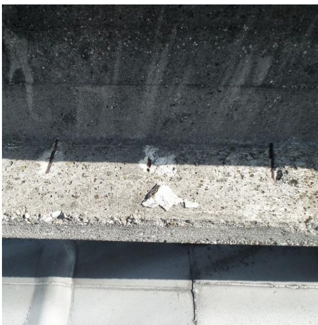
Slika 25: odstopanje betona, armatura korodirana spodnje pasnice
