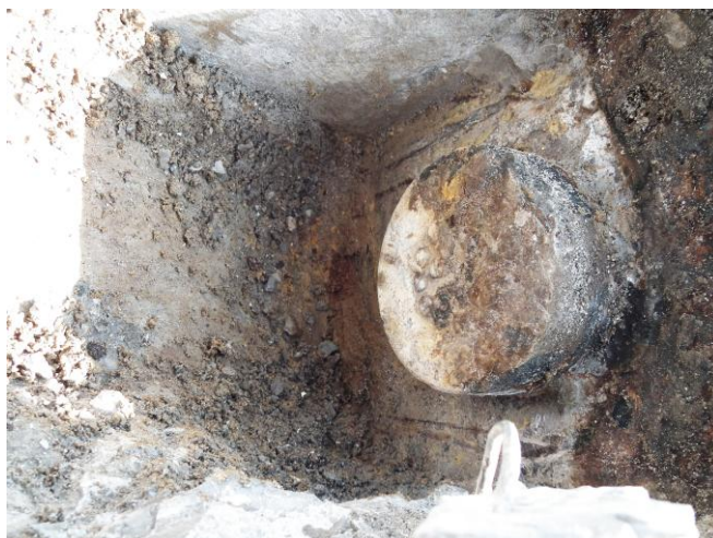
Slika 37: stanje sidrne glave in sidrne plošče
