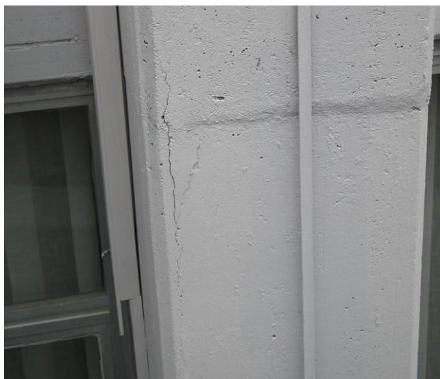
Slika 84: navpična razpoka nad linijo armature
