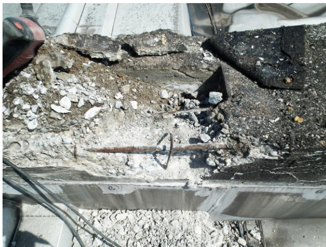
Slika 36: stanje armature in betona v predelu sidrne glave
