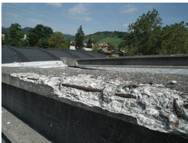
Slika 33: odpadanje betona roba, močna korozija armature
