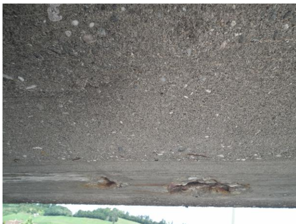
Slika 72: lokalna mesta odpadanje zaščitnega sloja, korozija armature
