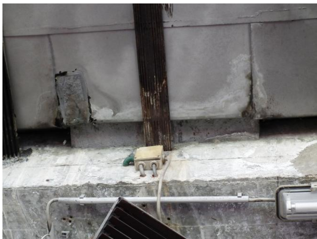
Slika 129: zamakanje skozi strešno kritino, korozija žic, močenje nosilca in stebra S9
