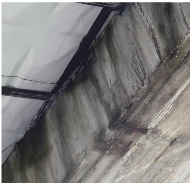
Slika 114: zamakanje vode v S-V delu glavnega nosilca
