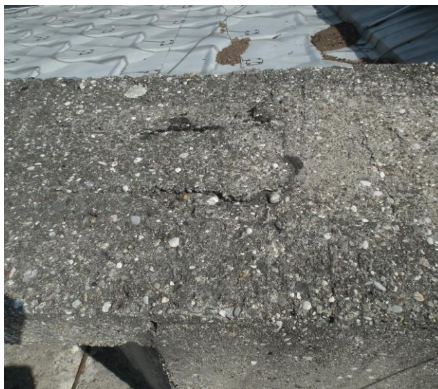
Slika 57: razpokan beton v predelu sidrne glave ob glavnem ločnem nosilcu
