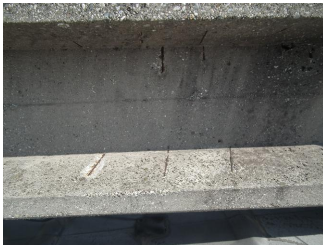
Slika 50: odstopanje zaščitnega betona, armatura korodirana
