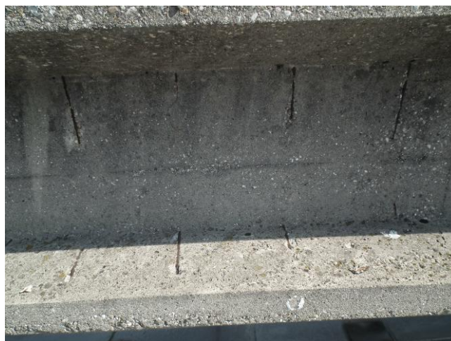
Slika 31: odstopanje betona, armatura korodirana
