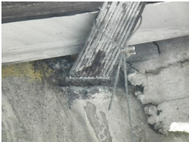
Slika 115: površinska korozija žic pramena, pronicanje vode
