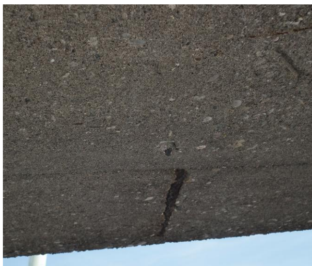
Slika 67: lokalna mesta odpadanje zaščitnega sloja, korozija armature
