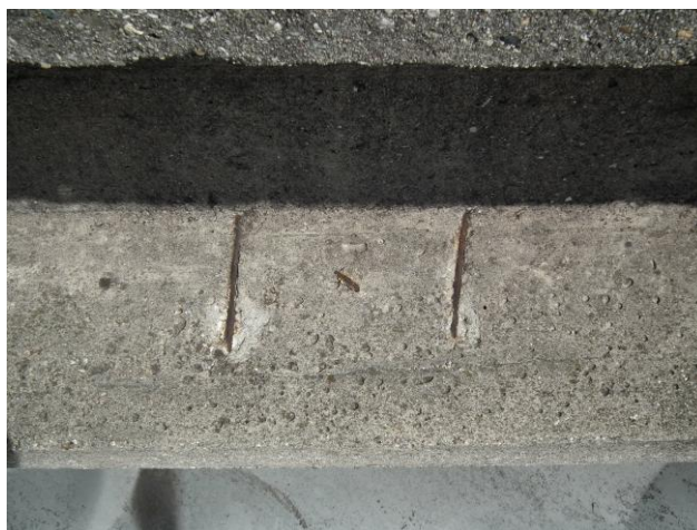
Slika 68: odstopanje betona, armatura korodirana
