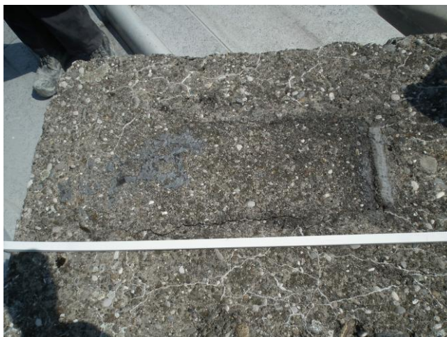
Slika 11: razpoke med sekundarnim in primarnim betonom
