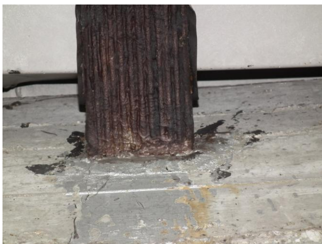
Slika 130: korozija žic pramena med S10 in S11
