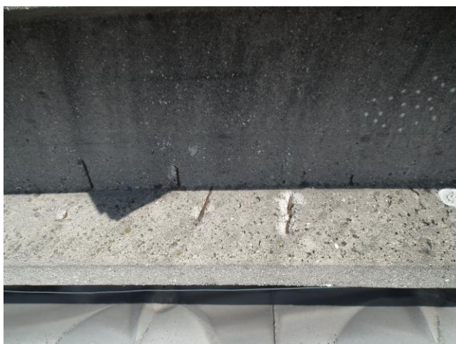
Slika 40: odstopanje zaščitnega betona, armatura korodirana
