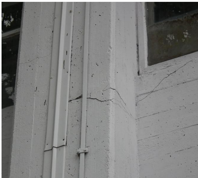
Slika 94: širša razpoka v stebri in zidu
