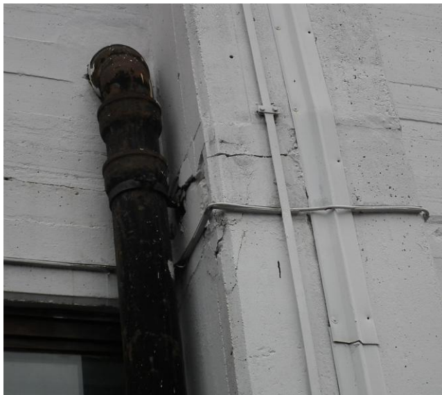
Slika 79: širša razpoka in zlom betona
