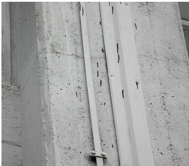
Slika 81: razpoka v stebru 5, ki poteka v liniji roba vmesne stene
