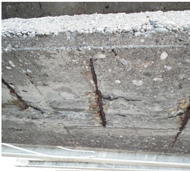
Slika 10: odpadanje zaščitnega sloja, korozija armature
