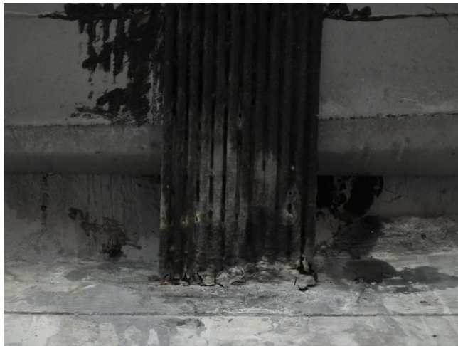
Slika 131: korozija žic pramena nad stebrom S11
