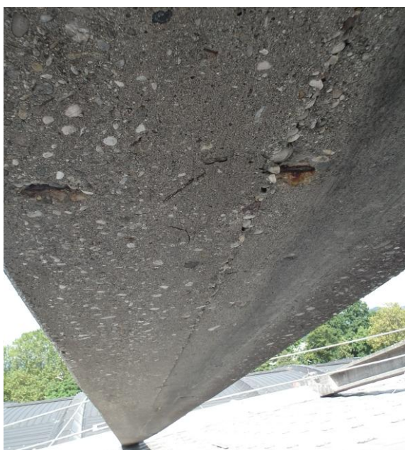
Slika 28: stanje betona spodnje površine spodnje pasnice
