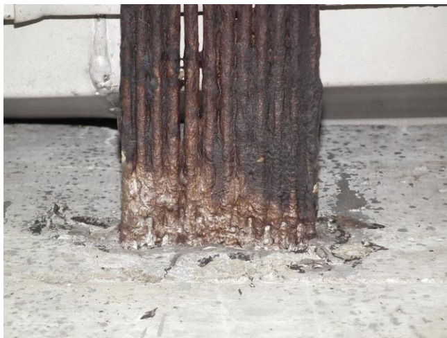
Slika 132: korozija žic pramena med S11 in S12
