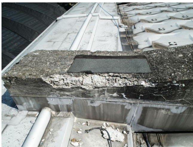
Slika 34: razpadanje betona v predelu sidrne glave na zahodnem delu nosilca
