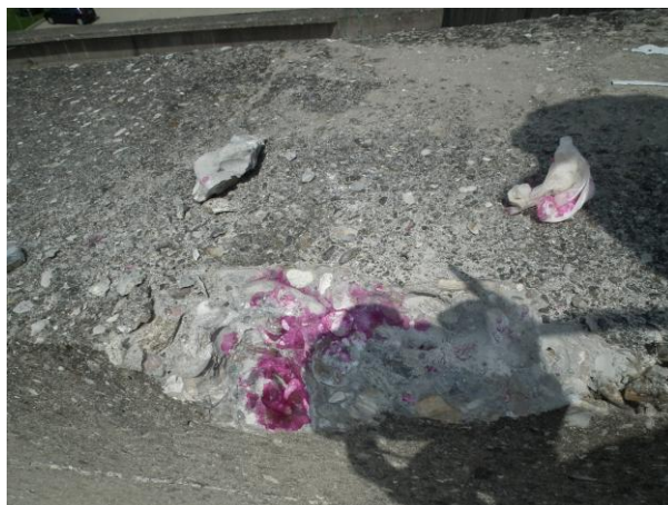
Slika 70: globina karbonatizacije N11
