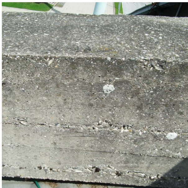
Slika 75: razpoke in slojevitost betona
