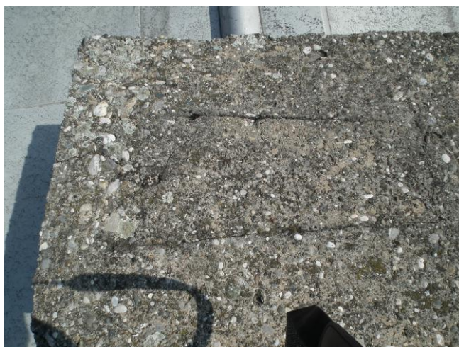
Slika 17: razpoke me sekundarnim in primarnim betonom na zahodni
