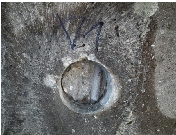
Slika 4: sonda V1, armatura brez korozivnih produktov
