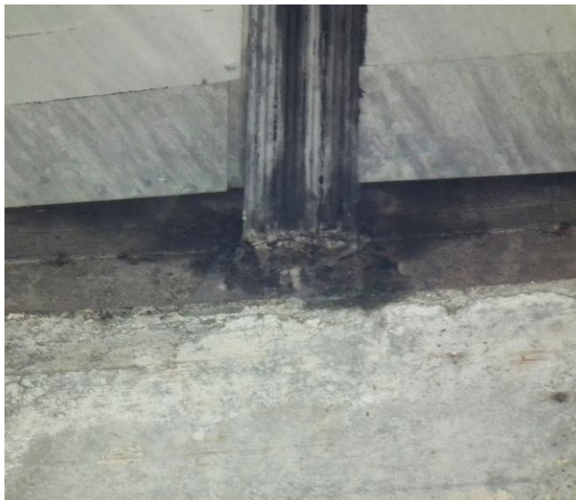
Slika 116: pričetek korodiranja 32. linije pramen
