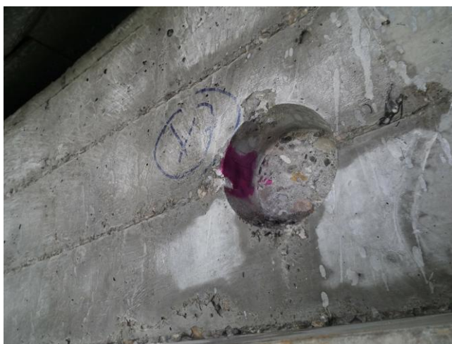
Slika 102: globina karbonatizacije, zunanji nosilec
