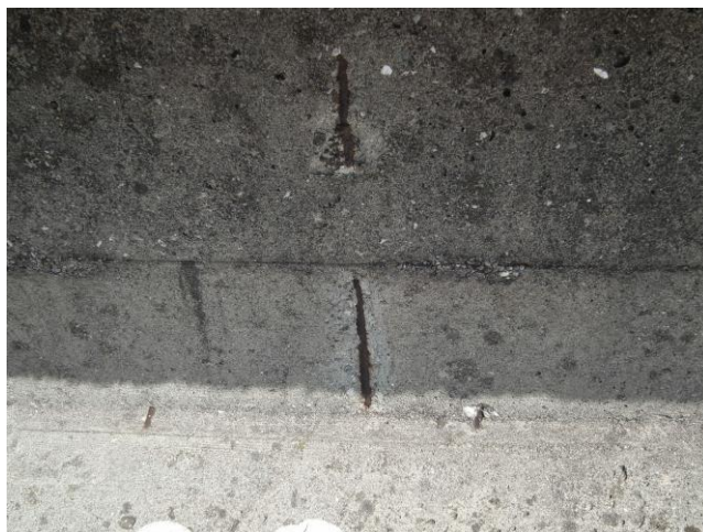
Slika 64: odstopanje betona, armatura je korodirana
