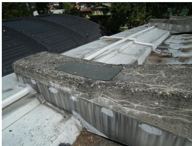
Slika 48: stanje betona v predelu sidrne glave na zahodu
