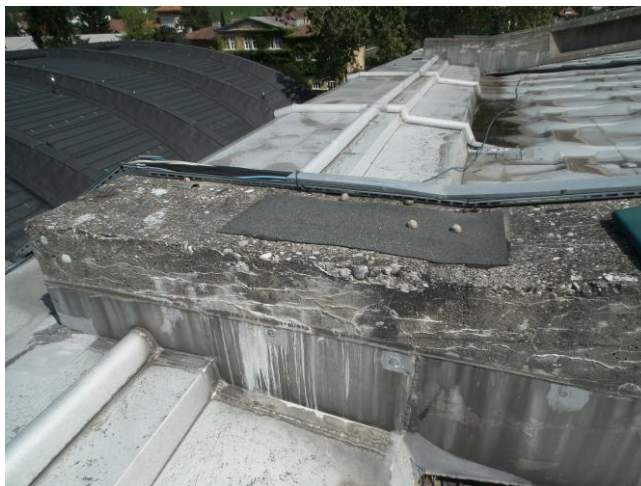
Slika 43: razpokanost betona v predelu sidrnih glav
