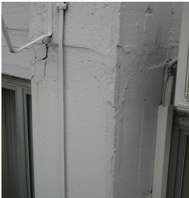
Slika 90: navpična razpoka v liniji armature, zlom betona
