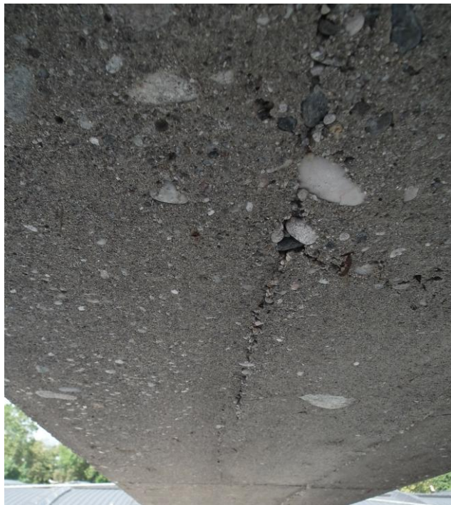
Slika 47: razpoka v opaznem stiku spodnje površine
