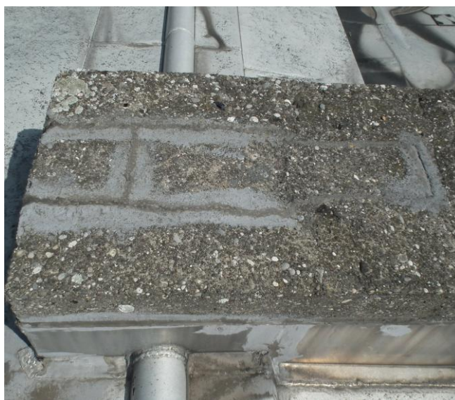
Slika 58: razpokan beton v predelu sidrne glave na zahodnem delu nosilca
