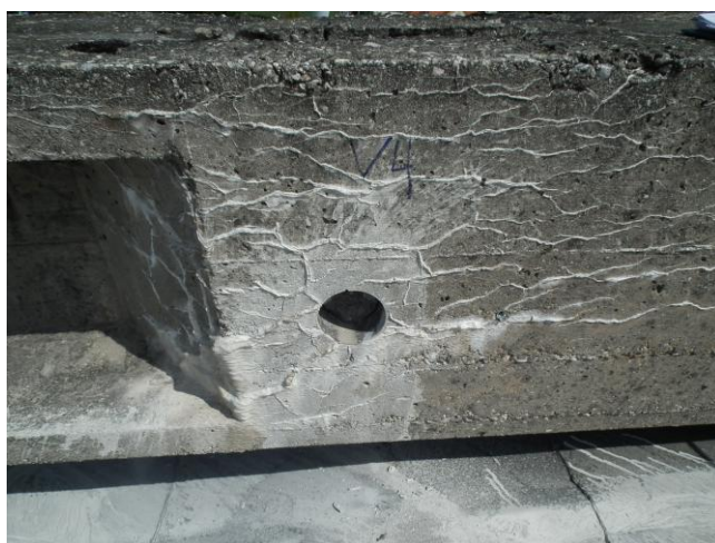
Slika 63: razpokanost betona, mesto odvzema vzorca V4
