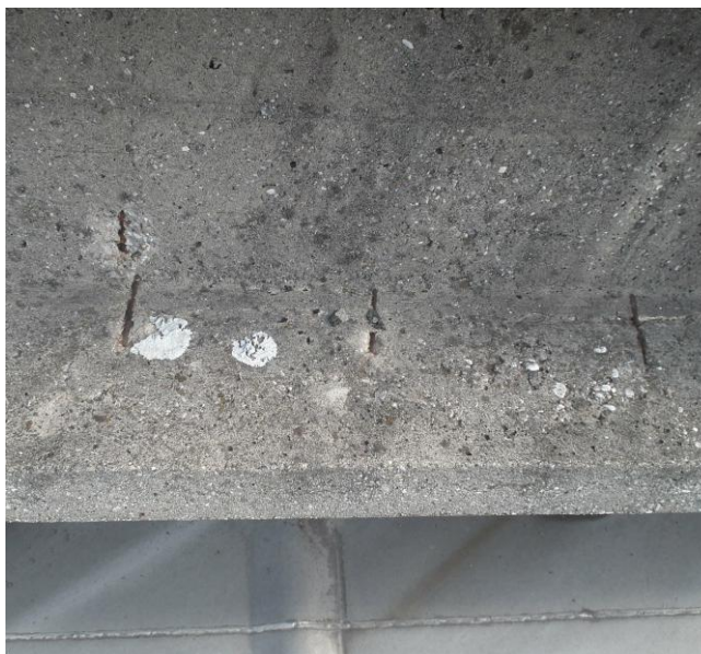
Slika 21: lokalno odstopanje betona, armatura je korodirana
