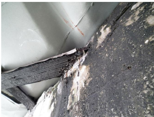
Slika 120: močna korozija žic 13. linije pramen
