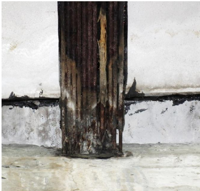
Slika 125: intenzivna korozija žic pramena v predelu stebra S7
