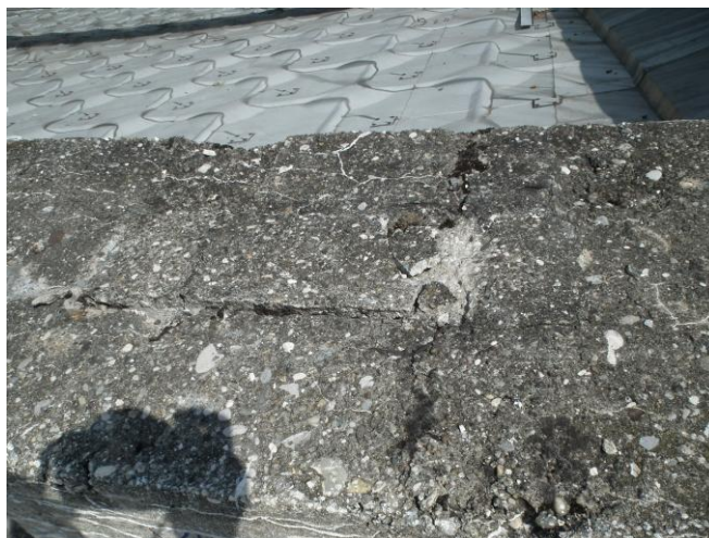
Slika 62: razpoke med sekundarnim in primarnim betonom
