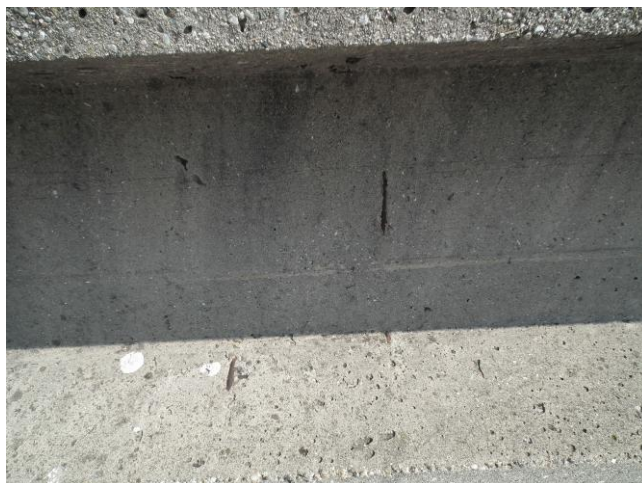
Slika 46: odstopanje zaščitnega betona, armatura korodirana
