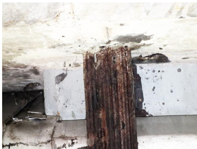
Slika 122: prikaz intenzivne korozije žic pramena desno od S5
