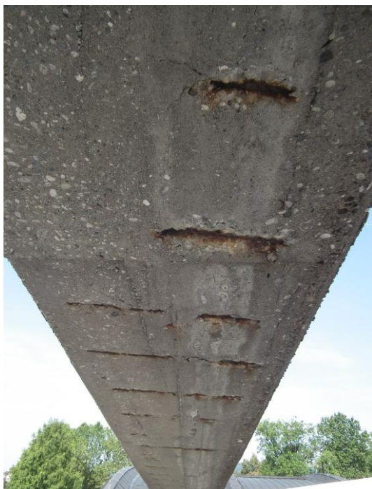
Slika 15: odpadanje zaščitnega sloja, korozija armature
