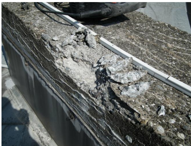
Slika 12: razpokanost nosilca na zahodni strani
