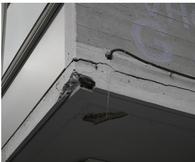
Slika 87: razpoka v stiku, odpadanje betona, korodirana armatura
