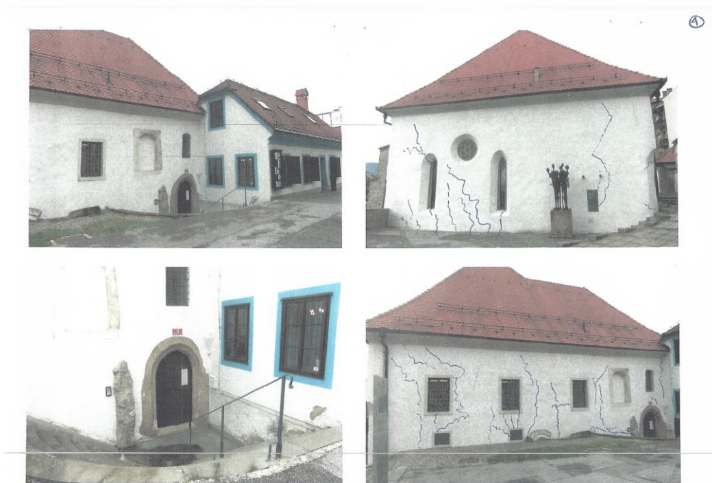
Slika 1: Obstoječe stanje Sinagoge – zunanost (prikaz lasastih in statičnih razpok v fasadnem ometu).
