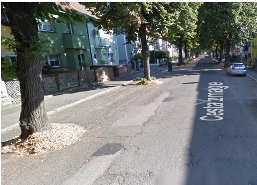
Slika 7: Poškodbe na obstoječem cestišču
