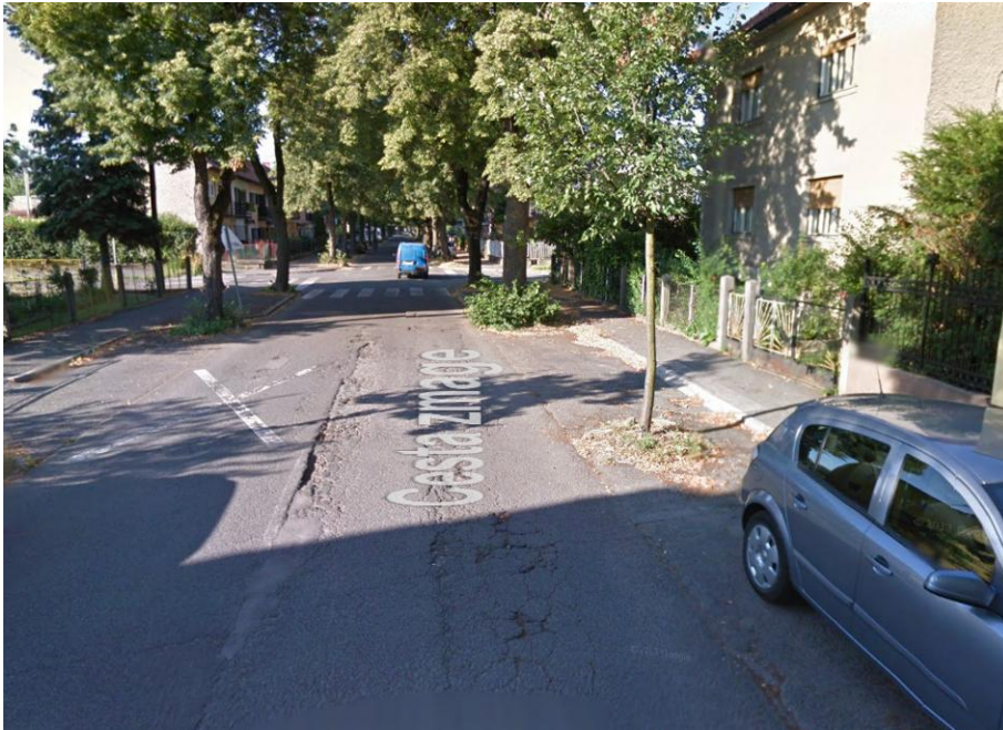
Slika 8: Poškodbe na obstoječem cestišču
