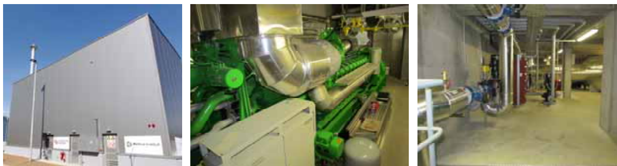
Slika 2: Objekt TOM III. – kogeneracijsko postrojenje
