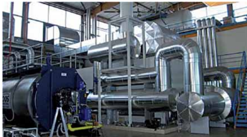
Slika 1: TOM I. – kogeneracijsko postrojenje
