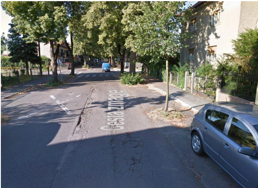
Slika 8: Poškodbe na obstoječem cestišču
