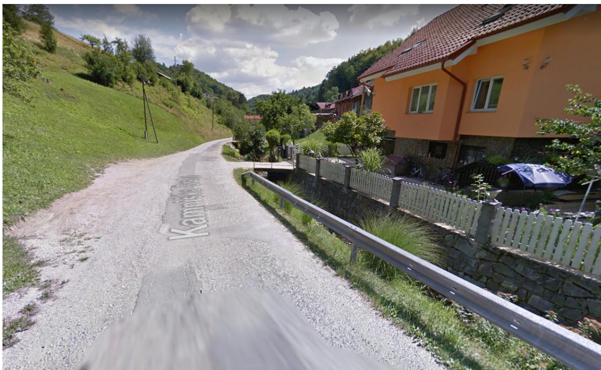
Slika 6: Poškodovano cestišče Kamniške grabe (vir: Google maps)
