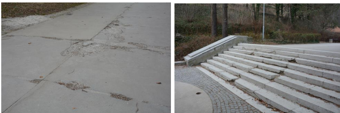
Slika 4-5: Mestni park Maribor – vidne poškodbe betonskih plošč in stopnišč
