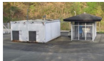
Slika 3: Črpaljšča termalne vode v Stražunu na vrtini MB-2/91 (levo zalogovnik za termalno vodo in desno pogonska enota) (fotografija: Denis Žnidarič)
