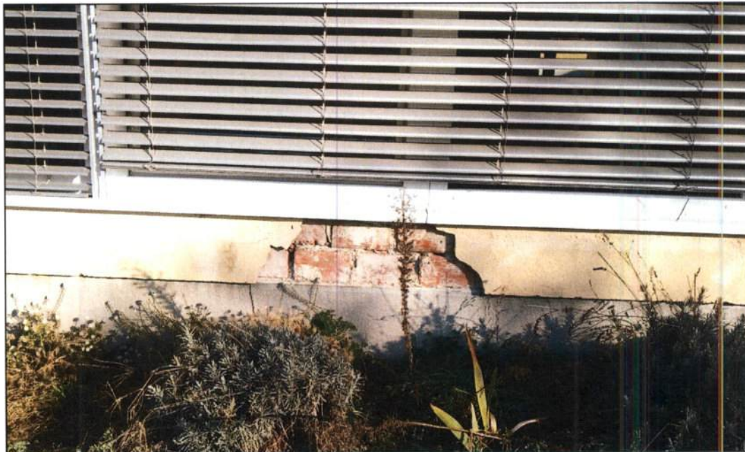
Slika 4: Fotografija dotrajanega objekta enote Ribiška.
