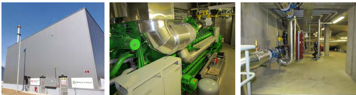
Slika 4: Objekt TOM III – kogeneracijsko postrojenje
