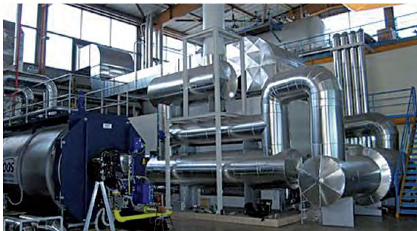
Slika 3: TOM I – kogeneracijsko postrojenje
