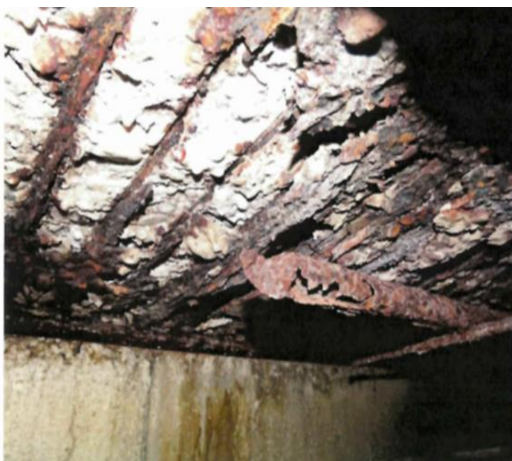
Slika št.9: Razpadanje betona in močna korozija armature (večina armaturnih palic je prekorodiranih oziroma so ostali samo korozijski produkti) plošče ob stiku z bazenom v predelu prostora s stebrom skakalnice – detajl 3 (vogalni del prostora HV).
