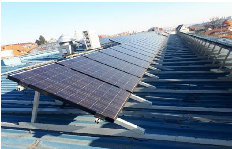
Slika 12: Streha s fotovoltaiko
