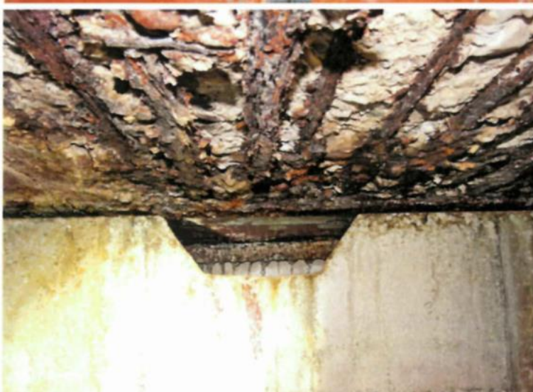
Slika št.8: Razpadanje betona in močna korozija armature plošče ob stiku z bazenom v predelu prostora s stebrom skakalnice – detajl 2 (vogalni del prostora HV).
