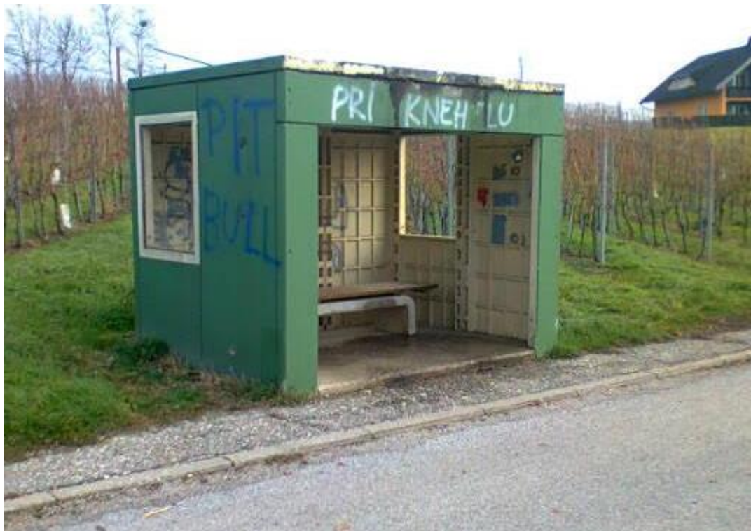
Slika 4: Primer nadstrešnice dotrajanega videza 3
