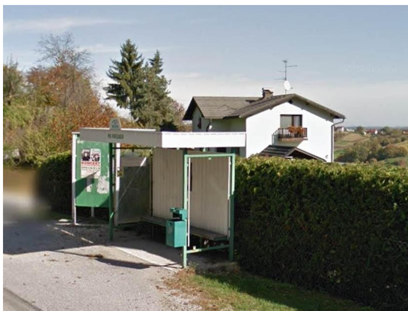
Slika 1: Primer nadstrešnice dotrajanega videza 1
