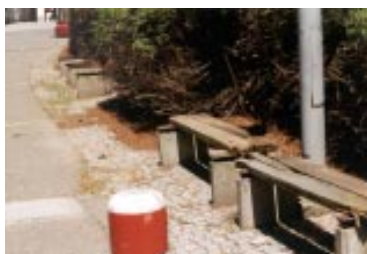
DOTRAJANE KLOPI V VETRINJSKI ULICI PRED OBNOVO
