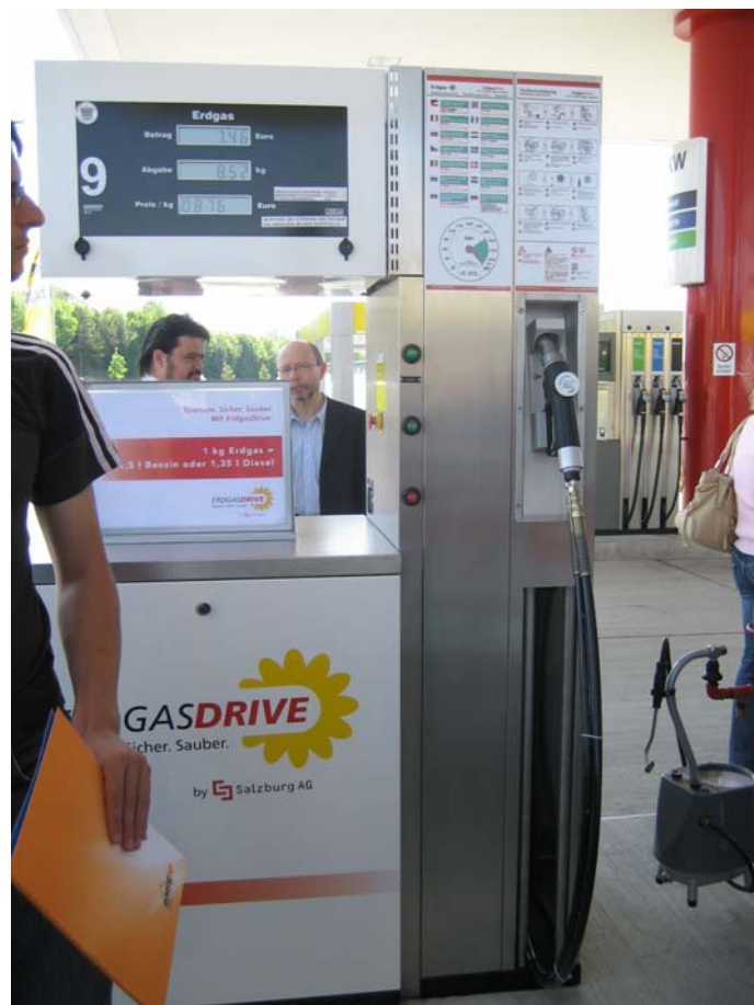
Črpalka stisnjene zemeljskega plina – CNG
